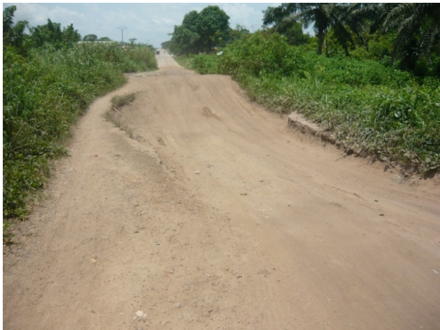
Photo 1 : Route en état de dégradation sur l'axe Lopou-Yomidji
