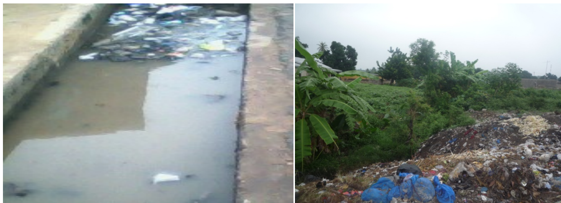
Figure 6 : Dépôt d'ordures à ciel ouvert et caniveau bouché au quartier commerce
